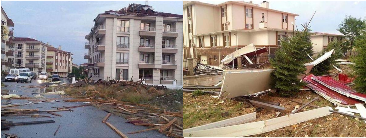
Şekil 12. Çubuk'ta 15.08.2015 tarihinde saat 16:11 meydana gelen fırtına sonucunda çatılar uçmuş, minare yıkılmıştır.
