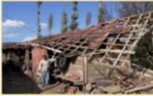
Çorum'un Gökçe kaya Köyünde Aşın Yağış ve Fırtınada Hasar Gören Ev 15 Ağustos 2001
