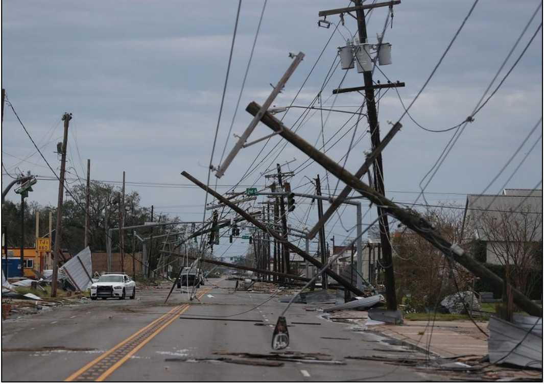
Şekil 36. ABD'de Lake Charles, Louisiana'da Laura Kasırgası Hasarına Ait Bir Görüntü (27 Ağustos 2020) ( https://www.theatlantic.com/photo/2020/08/photos-aftermath-hurricane-laura/615781/ )
